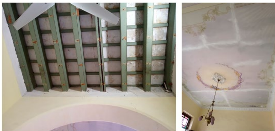
Figs. 5 y 6. Vista de la composición interior de la cubierta de la vivienda.
