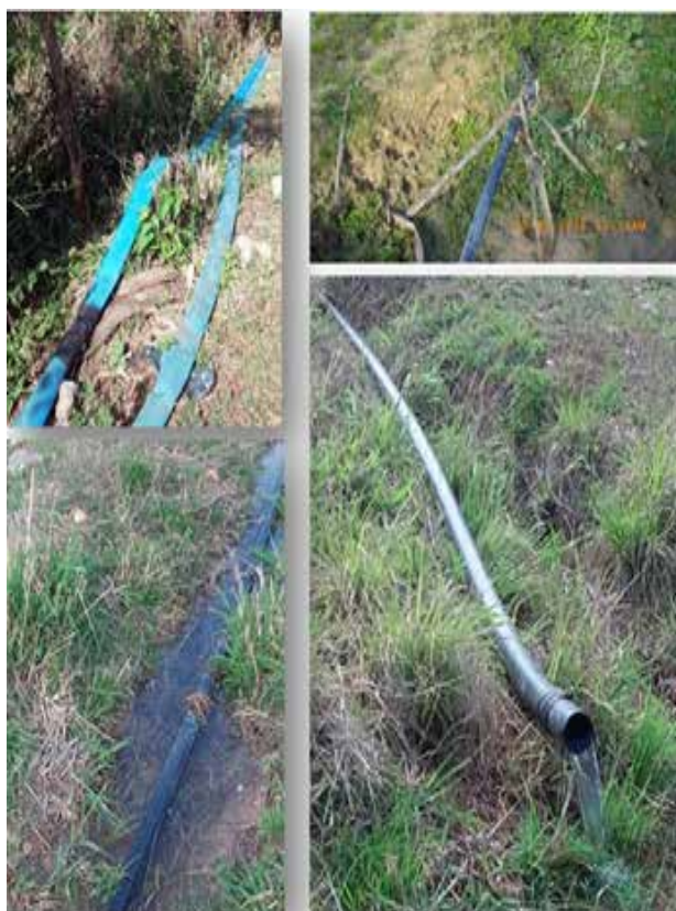
Fig. 3. Acometidas ilegales improcedentes.
