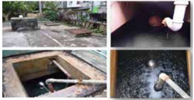
Fig. 1. Fotos de flotantes Instalados.
