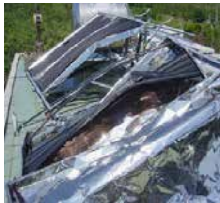
b) Destrucción de calentador solar sobre cubierta.
